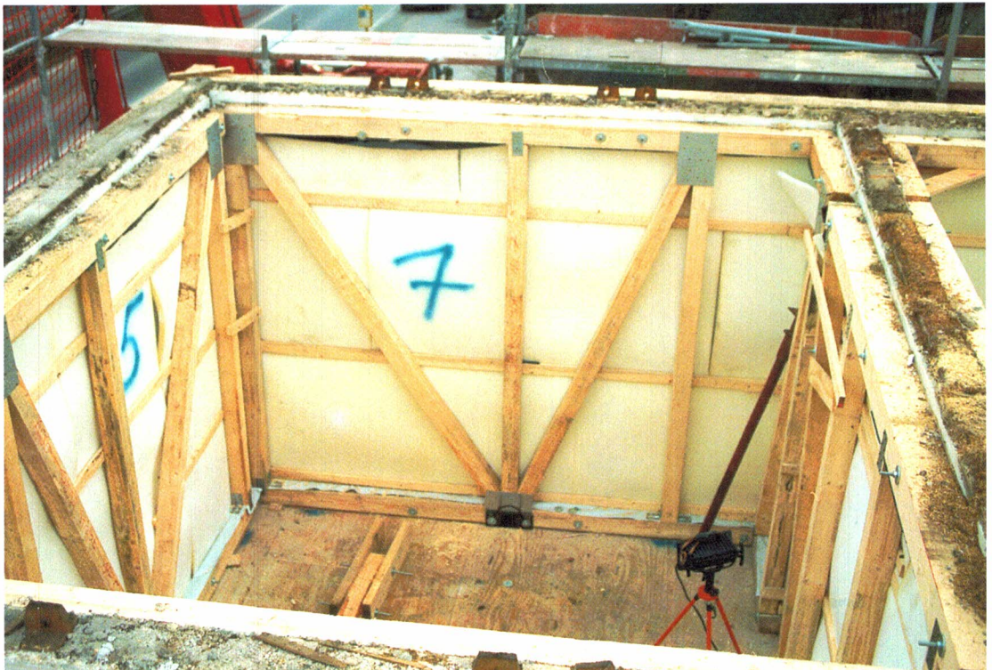
Nach der Entfernung der Decke ist hier gut die Verpackungskonstruktion der Wände zu erkennen
