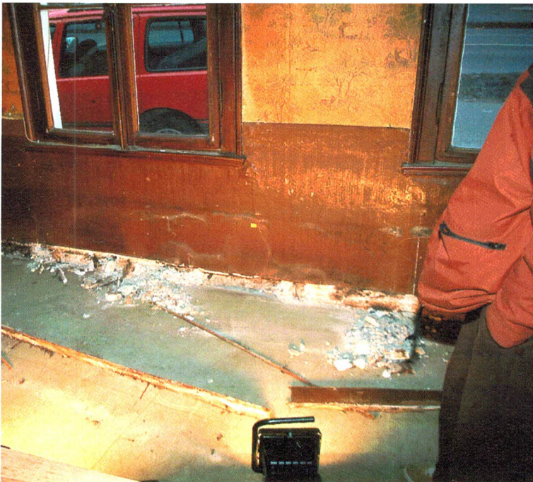
Schwere Feuchteschäden in der Gaststube: eine böse Überraschung bei den Bauuntersuchungen
